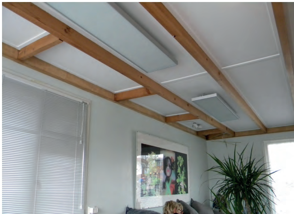
De infrarood panelen vlak onder het plafond gehangen.
